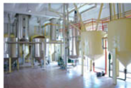
脱色系统 Bleaching system
