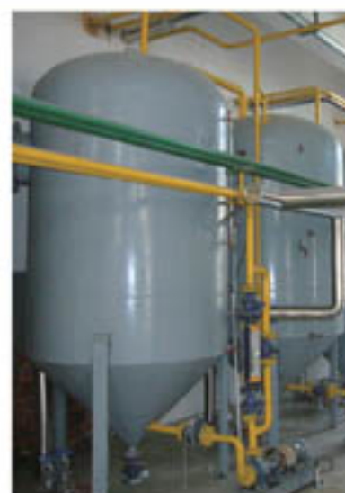
混合配比系统 Mixed proportion system
