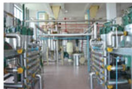
过滤系统 Filtration system
