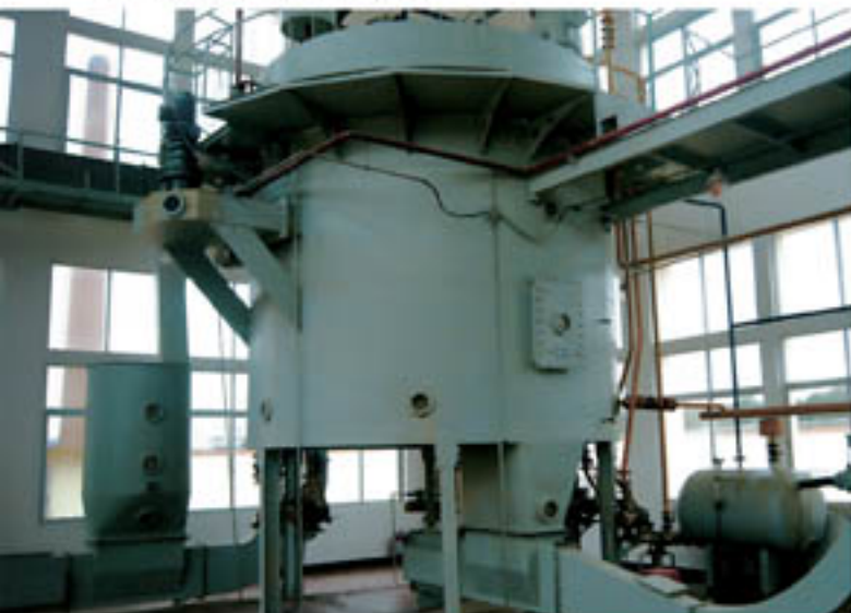
浸出系统 Extraction system
