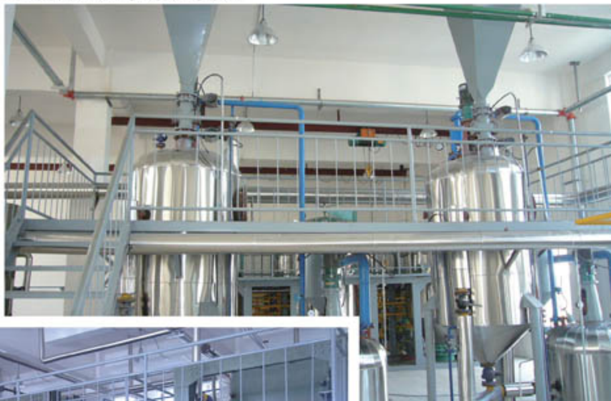
白土定量系统 Bleaching clay dosing system
